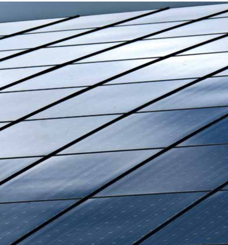
PV-Anlage (201 kWp), Kränzlin
